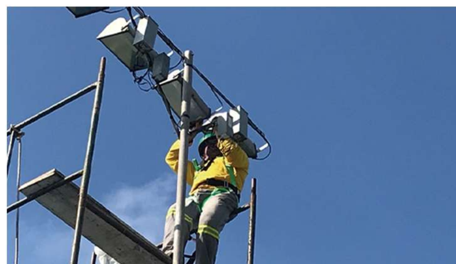
Nova iluminação das quadras de Tênis e Beach Tennis
